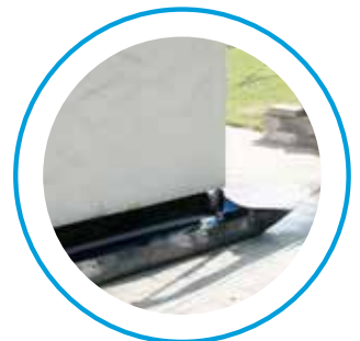
Das Abwasser wird mit Auffangwannen aufgefangen.
